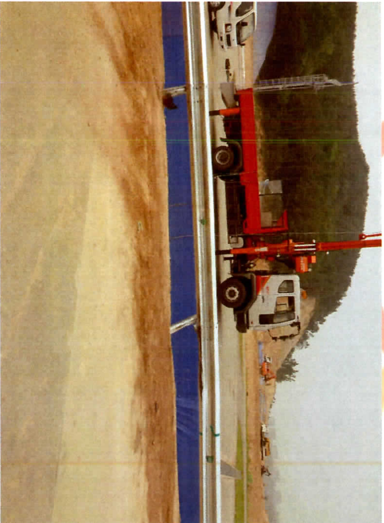
<소형차 시험 후 시설물 전면부>
